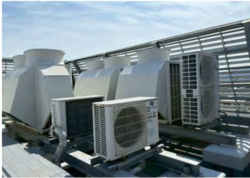
屋上にあるエアコン室外機
